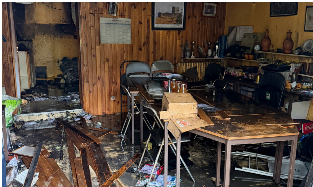
En 2 nuits, notre local a été entièrement détérioré par 2 engins incendiaires
